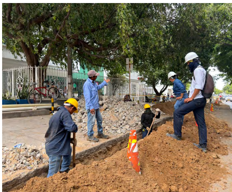
La renovación de redes en la calle 13 mejoró la infraestructura del acueducto para optimizar el suministro de agua en Riohacha.
