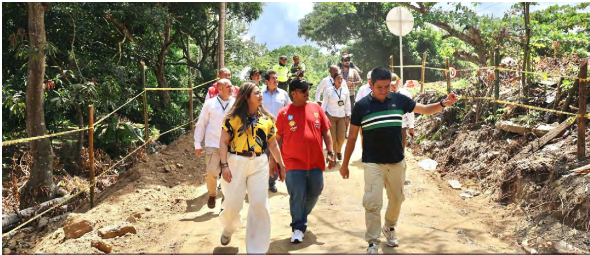
Habilitaron paso alternativo en MendiHuaca mientras avanza trabajos para instalar un puente metálico provisional tras el colapso de la estructura.
