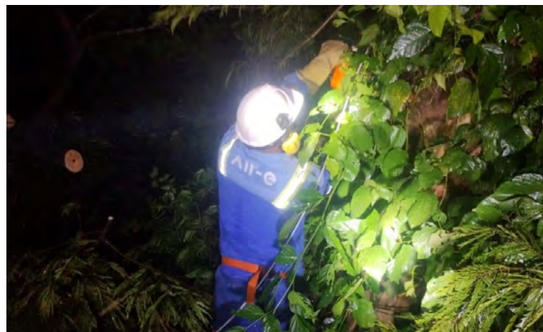
Air-e refuerza su operativa en La Guajira para asegurar la continuidad del servicio eléctrico durante la emergencia por lluvias.
