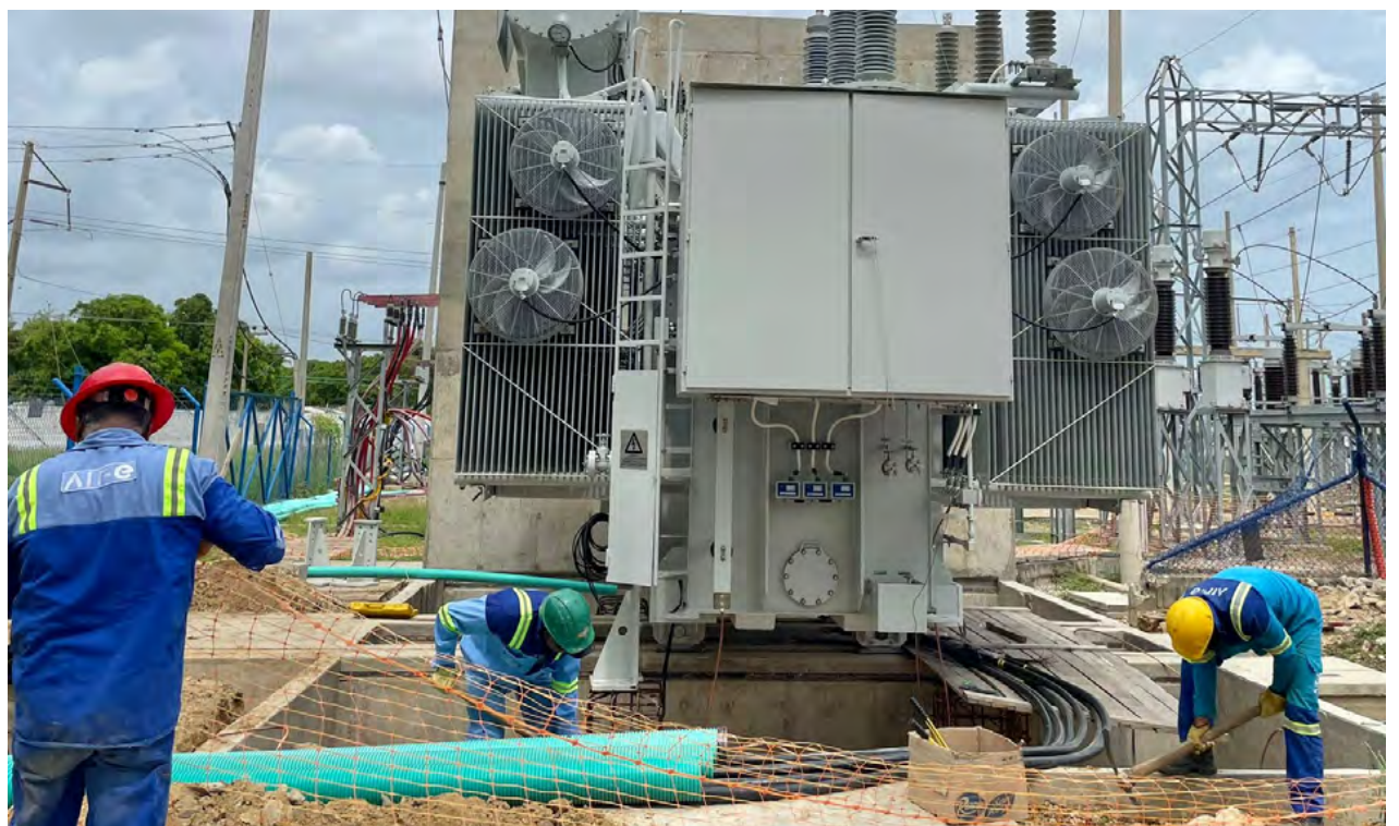
Air-e instalará un nuevo transformador en la subestación Riohacha para mejorar la confiabilidad y capacidad del servicio eléctrico en La Guajira.
