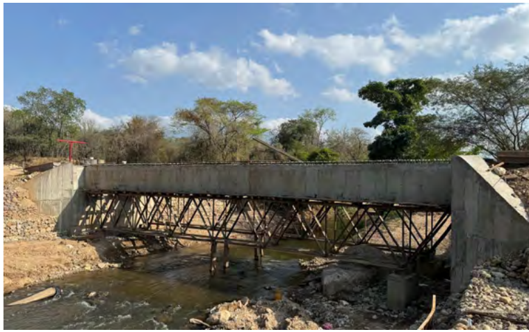
Esta obra, de 23 metros de largo y 5.7 metros de ancho, mejorará la movilidad y acceso para las comunidades de Barrancón, Campo Alegre y San Pedro.
