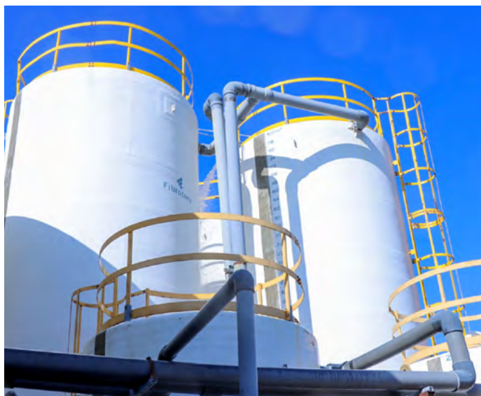
La planta, diseñada para producir 5.000 metros cúbicos diarios, entra en fase de prueba, marcando un logro significativo en la optimización del servicio de agua potable en la región.
