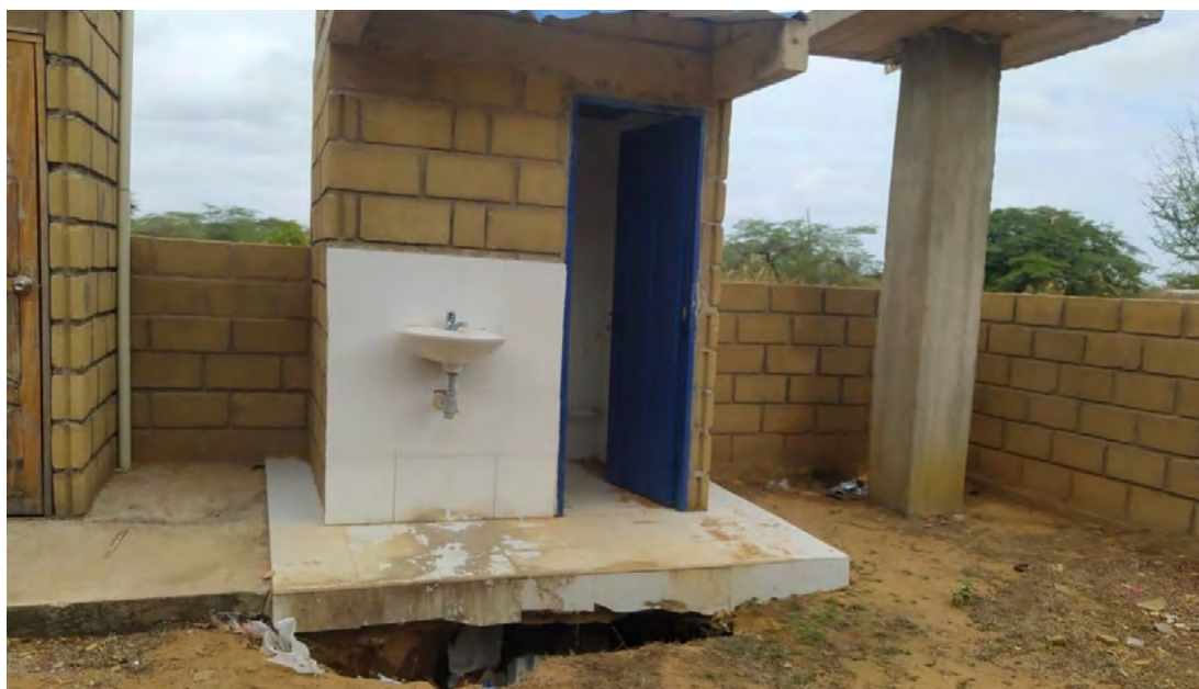
La situación dejó graves daños en la infraestructura.
