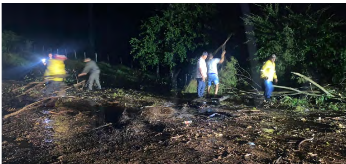
Levantamiento de bloqueo de vía que tenían desde el martes los habitantes del Corregimiento de Monguí.
