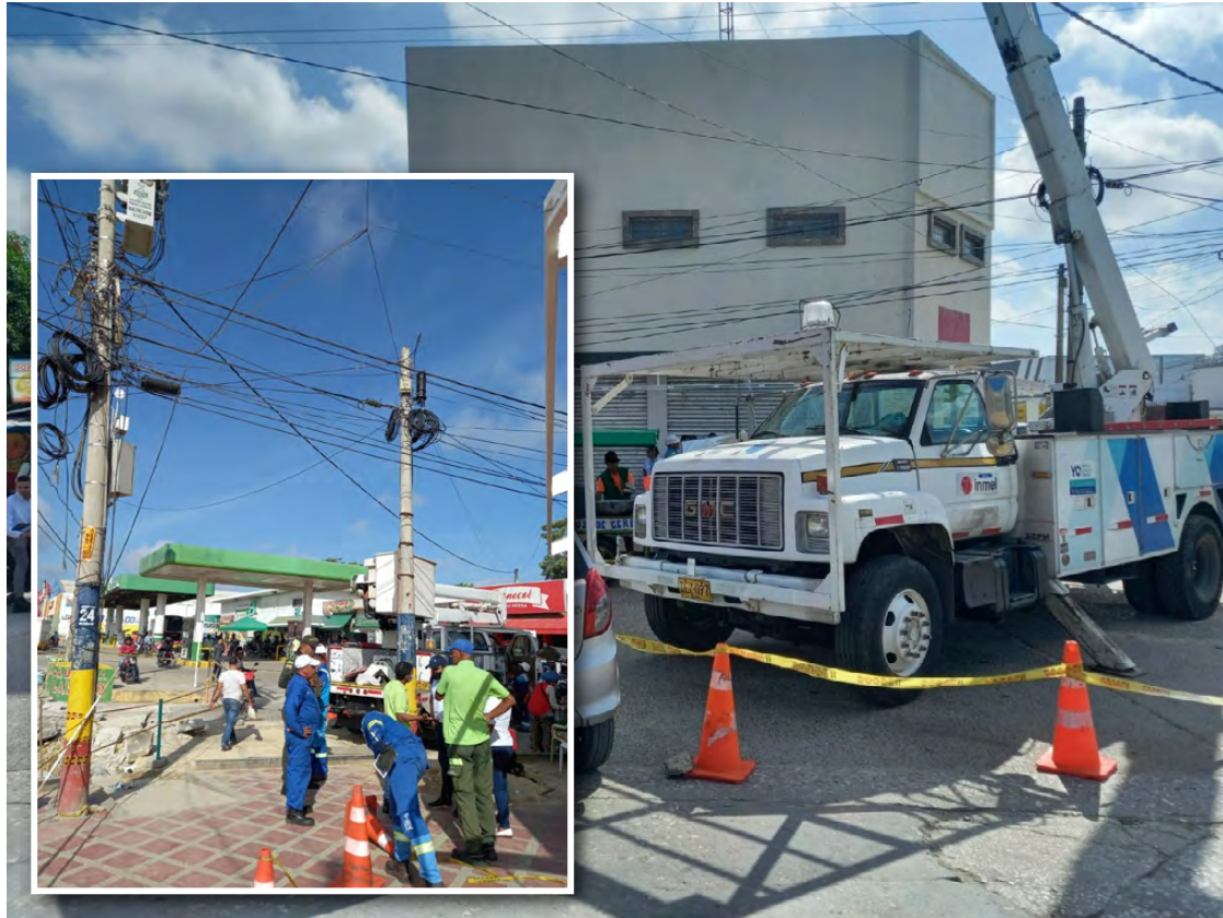
Suspensión del servicio de energía a estación de gasolina por deuda de más de 250 millones de pesos.
