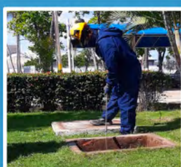
Mantenimiento de pozos sépticos
