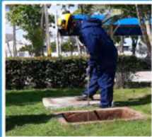
Mantenimiento de pozos sépticos
