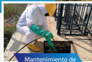
Mantenimiento de pozos sépticos
